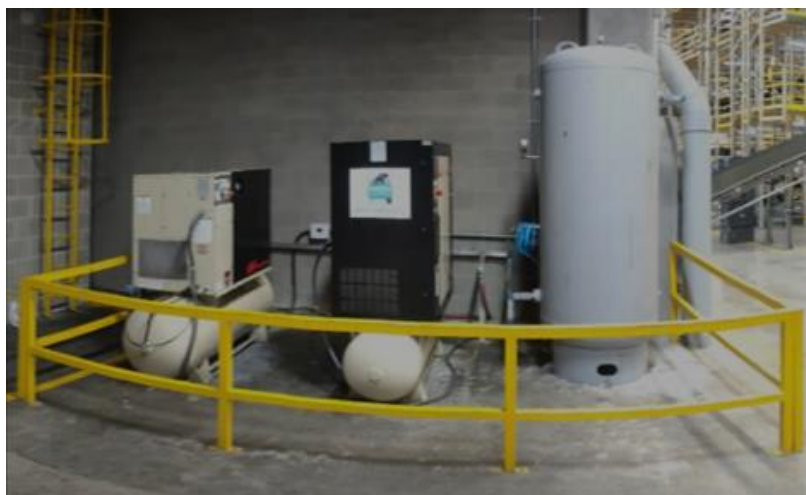
Figura 8. Sala de compresores de ARTYTECMO.
