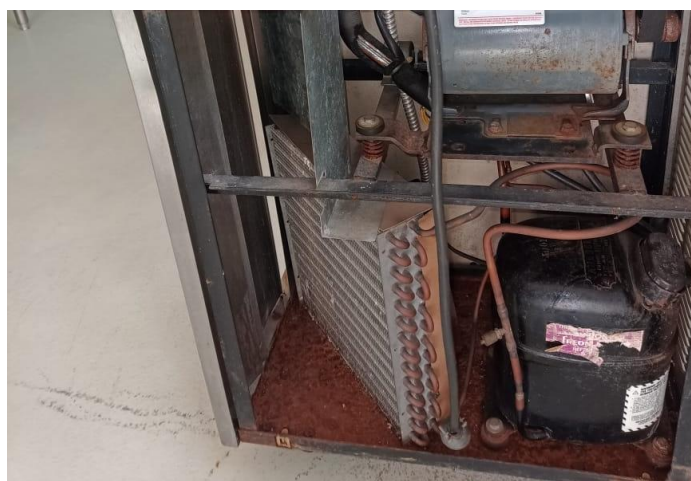
Ilustración 3. Lamina de reposo de compresor oxidado.
