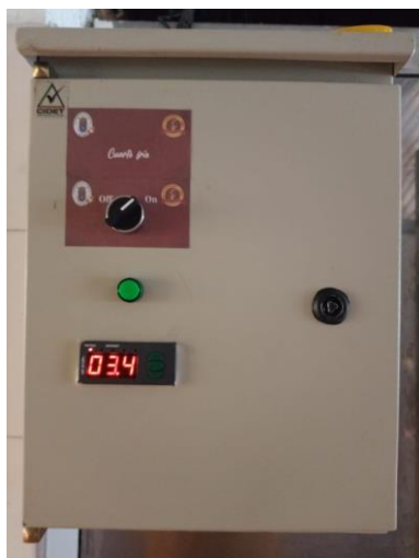
a. Cuarto refrigerando
