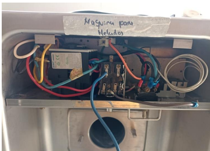
Ilustración 4. Estado del sistema eléctrico tablero de control.
