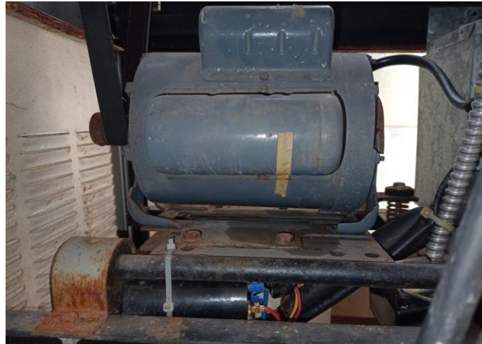
Ilustración 2. Estado de los componentes.
