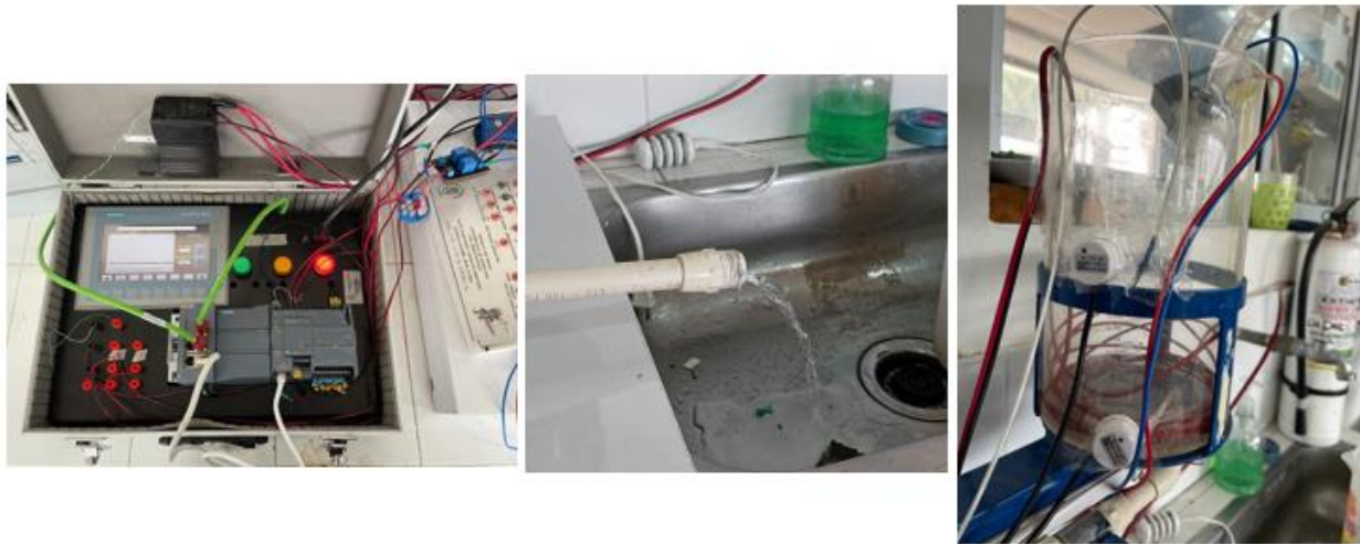
Ilustración28: Apagado de la de planta, indicador rojo encendido y tanque vacío
