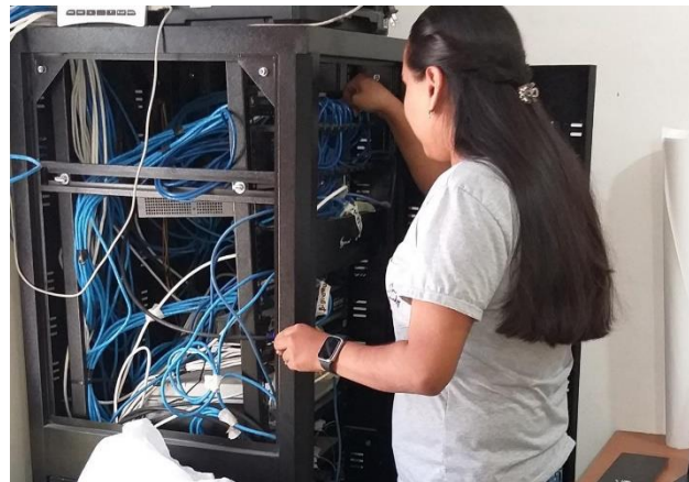
Figura 18. conexión del cables en el switch
