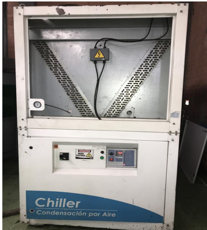
Figura 4. Chiller enfriador de agua
