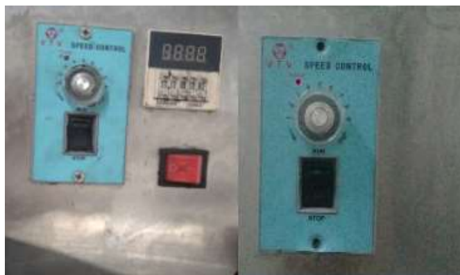
Figura 33: Control Tapas y Control separador
