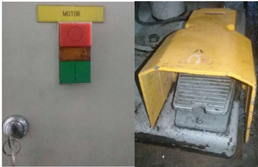
Figura 25: Tablero de Control Y Activador de Pedal
