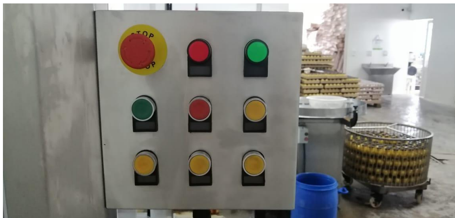
Figura 6-40. Resultado esperado de limpieza de tablero de control de Enlatadora
