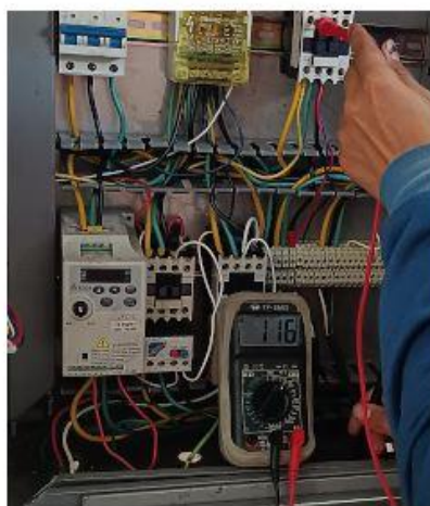
Voltaje de entrada
