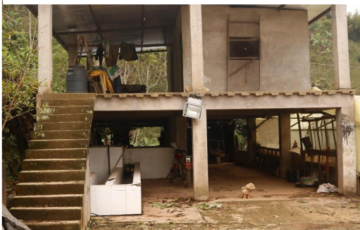
Fotografía 5 Instalaciones de despulpe, lavado y secado del café
