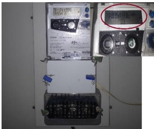
Contador de energía eléctrica
