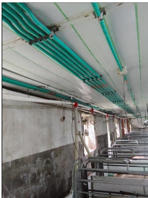
Ilustración 25. Tubería de distribución para el cableado
