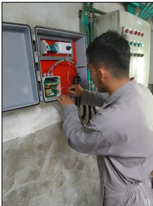
Ilustración 24. Instalación del equipo de monitoreo en el galpón de la maternidad (Mendieta, 2022)
