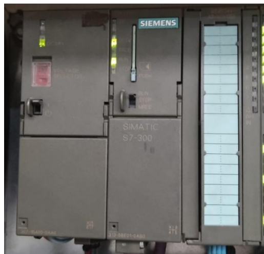
Figura 63. Plc Siemens S7-300. Fuente: Autor.
