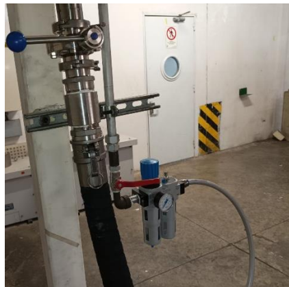
Figura 55. Instalación neumática a equipo auxiliar 1. Fuente: Autor.
