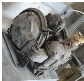
Figura 43. Equipo auxiliar 2(bomba sandpiper) antes de realizar mantenimiento. Fuente: Autor.
