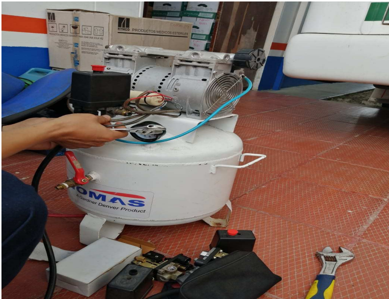
Fig. 87. Cambio del dispositivo que presentaba fallas (presostato) por uno nuevo.
