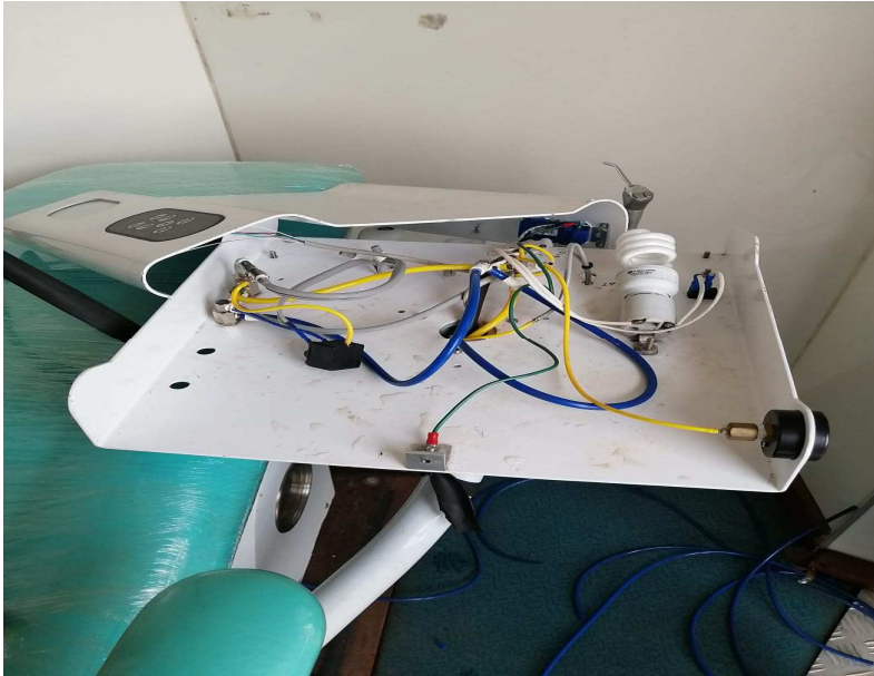
Fig. 90. Conexiones tanto eléctricas, hidráulicas y neumáticas de la unidad odontológica de la móvil de brigadas, se realizó cambio de la manguera azul, manguera conductora de agua ya que presentaba una fuga.
