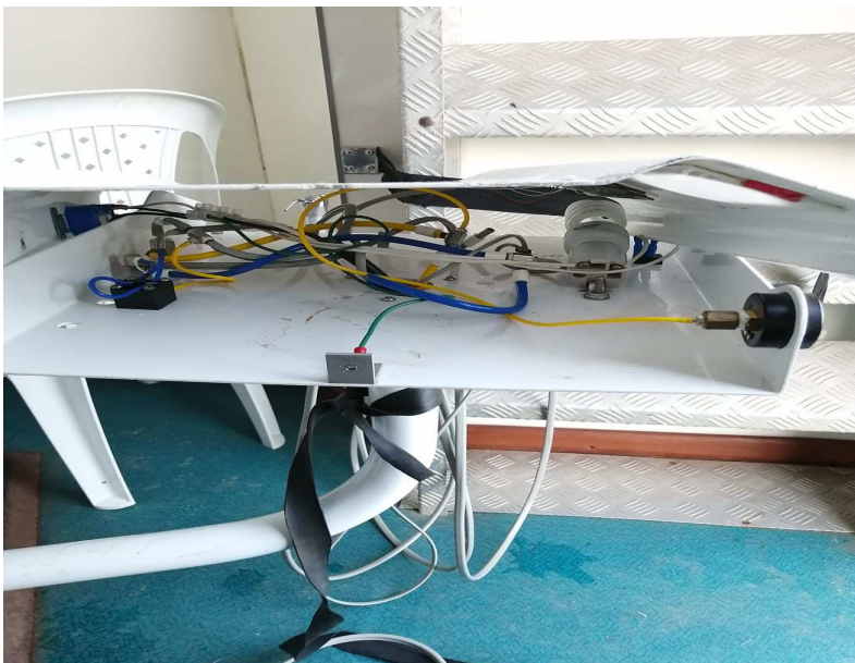
Fig. 91. Conexiones tanto eléctricas, hidráulicas y neumáticas de la unidad odontológica de la móvil de brigadas vista desde otro plano.
