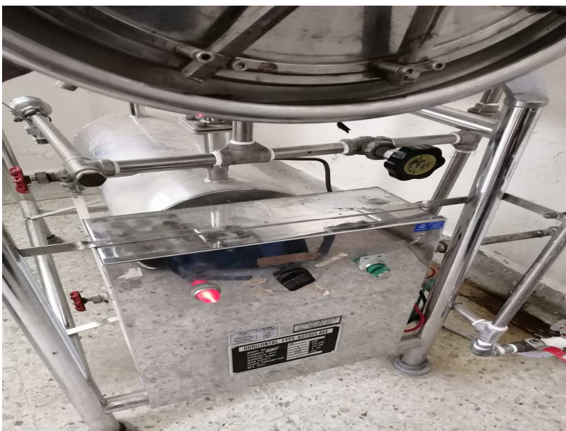
Fig. 36. Caja que contiene la parte eléctrica del equipo autoclave manual al que se le realizo el mantenimiento correctivo.
