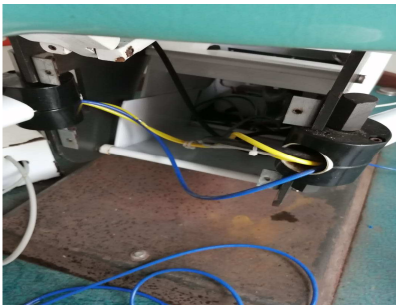
Fig. 89. Mangueras conductoras de aire y agua del equipo unidad odontológica de la móvil de brigadas, para lo cual se realizó cambio de la manguera azul, manguera conductora de agua que presentaba fugas.
