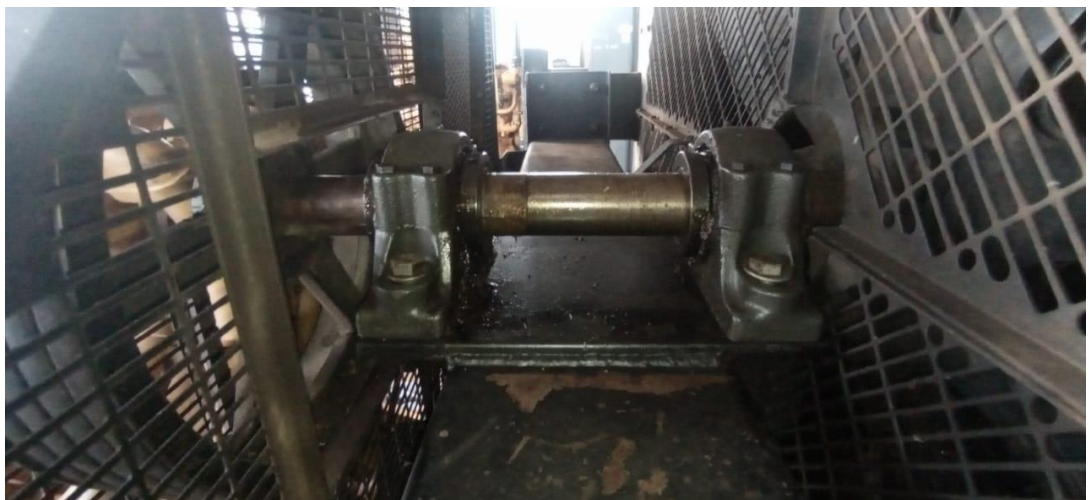
Ilustración 4. Rodamientos en chumaceras del eje en el sistema de transmisión de potencia del radiador para el motor a gas Caterpillar 3408
