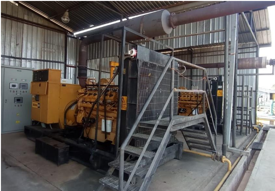
Ilustración 31. Generador a gas Caterpillar 3412.
