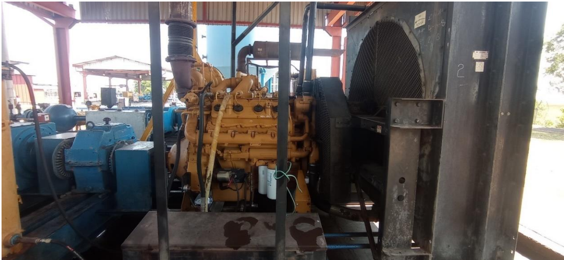
Ilustración 30. Conjunto de bomba recíprocante acoplada a motor Caterpillar 3408
