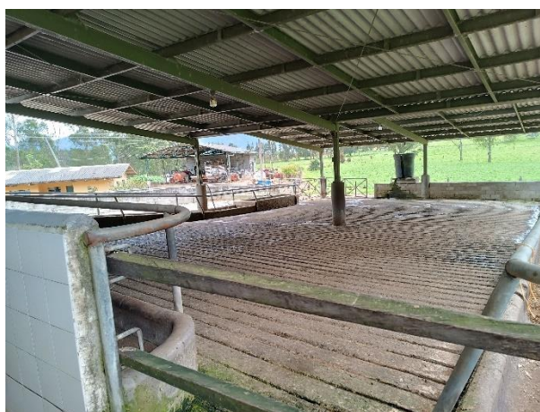
Figura 5. “Instalación Sala de Ordeño”
