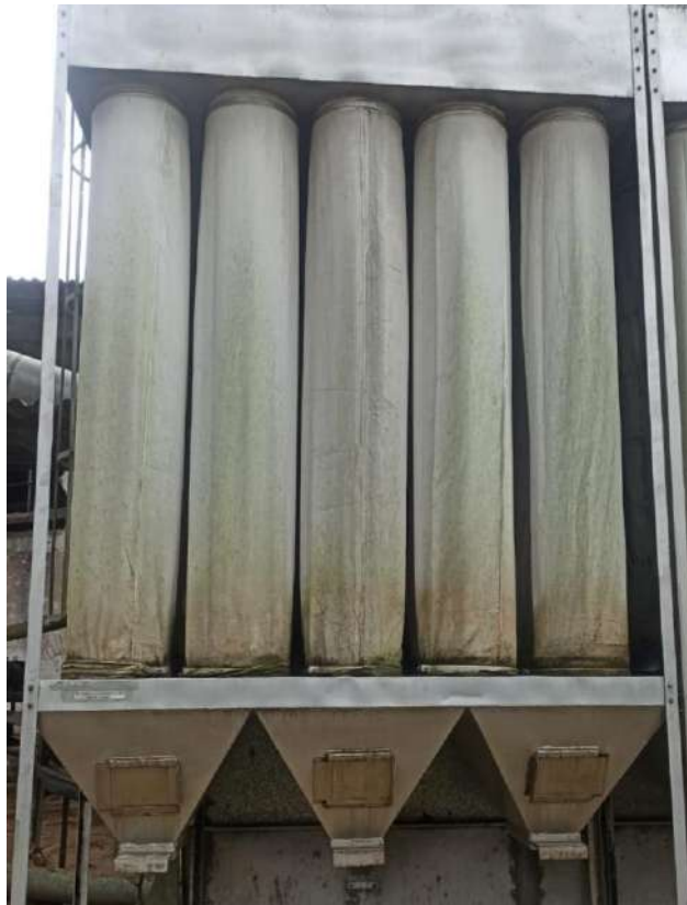
Figura 50 Filtro de mangas a la intemperie
