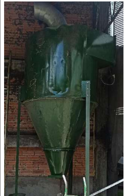
Figura 79 Instalación de separador ciclónico, ventilador y filtro de mangas
