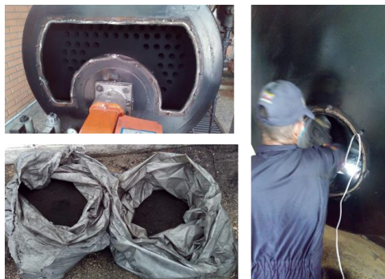
Figura 17: Mantenimiento preventivo de las calderas Dossier 150 BHP 1-477
