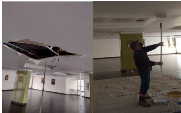
Figura 41: Reparación de filtración de agua en un salón de eventos Boyacá
