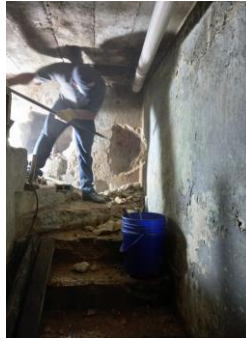
Figura 26: Verificación de filtraciones de agua en el túnel
