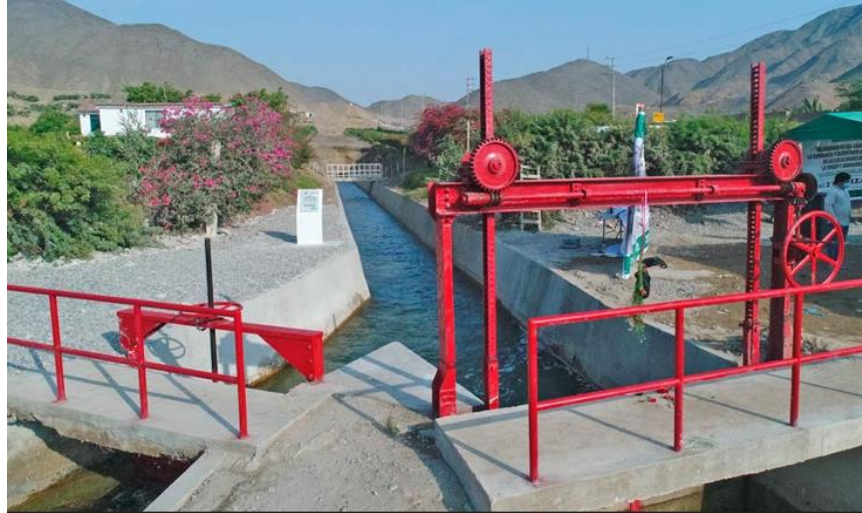
Figura 4. Toma de agua de una central fluyente.
