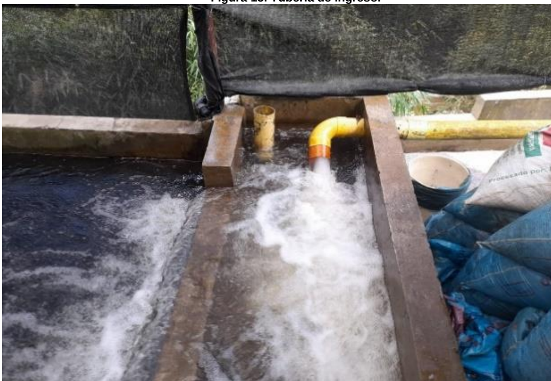
Figura 15. Tubería de ingreso.
