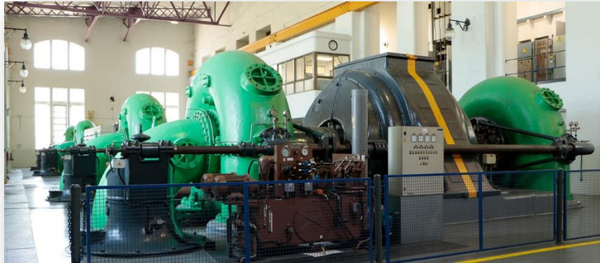
Figura 6. Sala de máquinas hidroeléctrica
