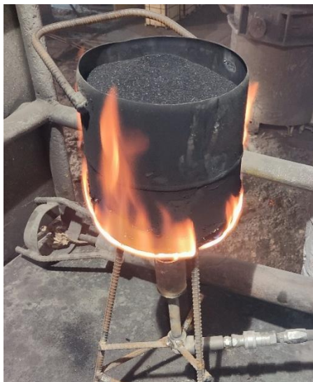
Figura 41. implementación de sistema de calentamiento
