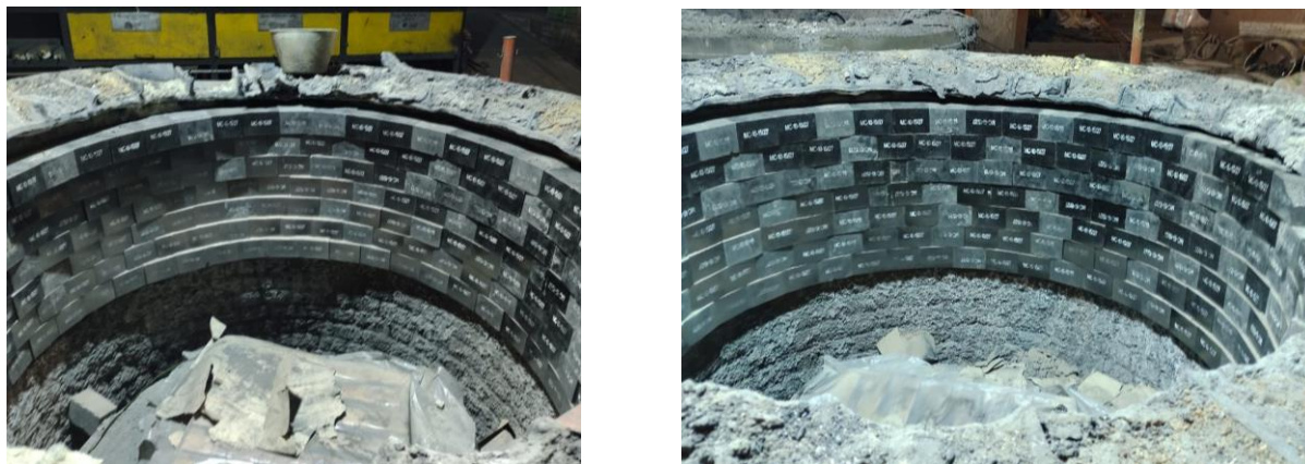
Figura 38. Cambio de línea de escoria en cucharas de colado
