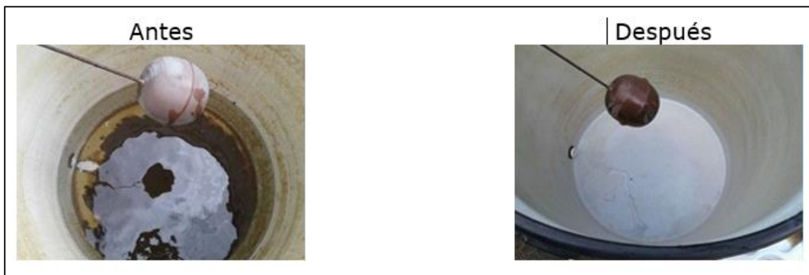
Figura 6. Evidencias del lavado de tanque de la Comercializadora el Gran Castillo.
