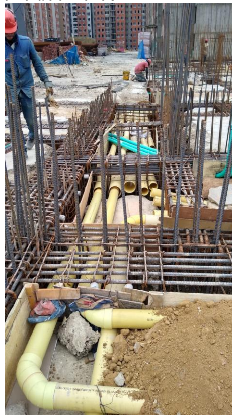
Ilustración 32. pases de tubería en vigas de cimentación Torre 8
