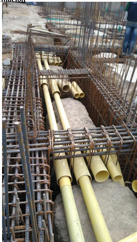
Ilustración 33. pases de tubería en vigas de cimentación
