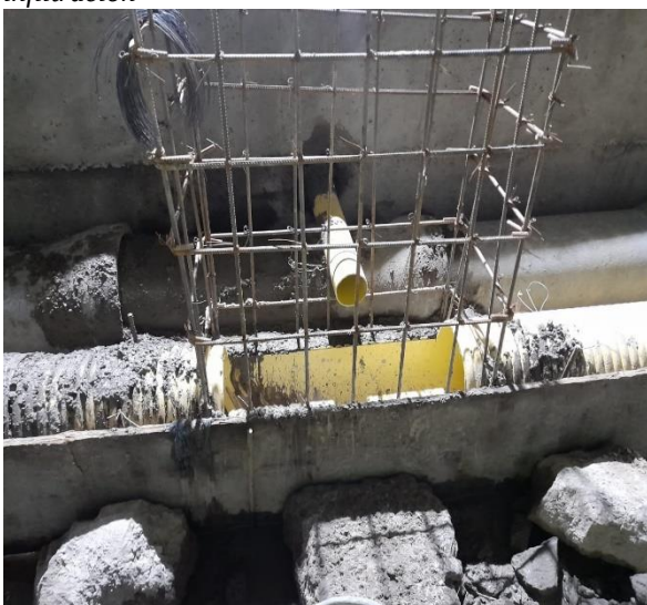
Ilustración 19 Figurado y conducto para aguas de infiltración
