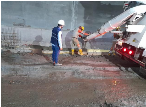
Ilustración 15 Inspección fundida de tubería
