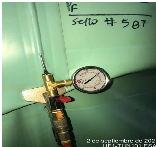
Ilustración 8 Manómetro empleado en mediciones pruebas de estanqueidad
