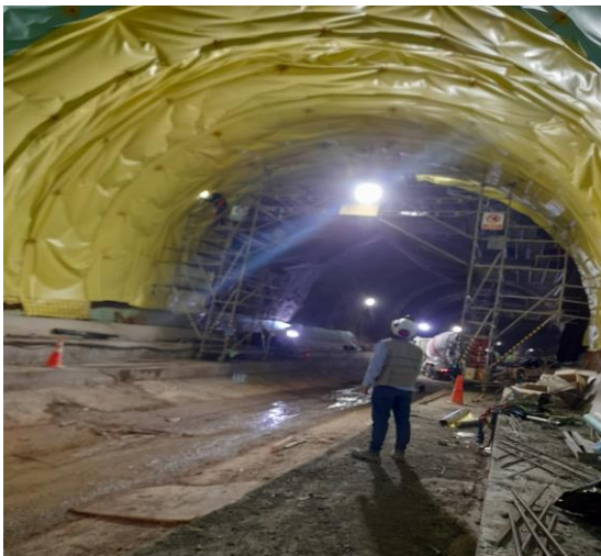
Ilustración 11 Supervisión visual de daños Geo membrana en bóveda
