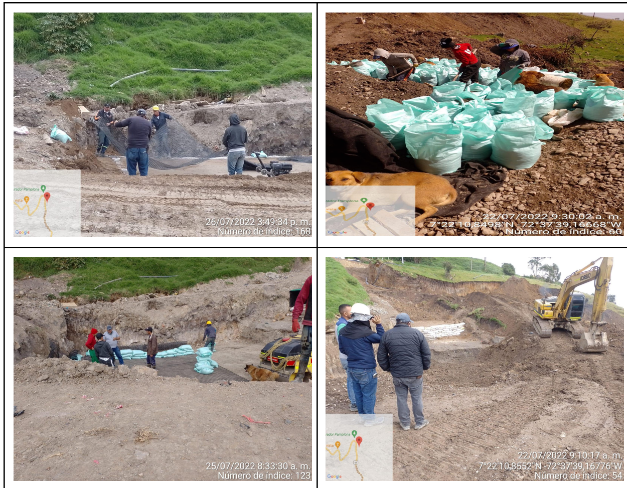
Figura 10. Evidencia fotográfica de la falta de utilización de los EPP
