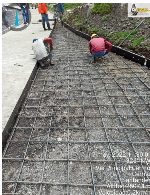
Figura 14 Acero de refuerzo en losas irregulares
