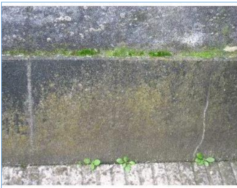
Ilustración 7 biodeterioro del concreto
