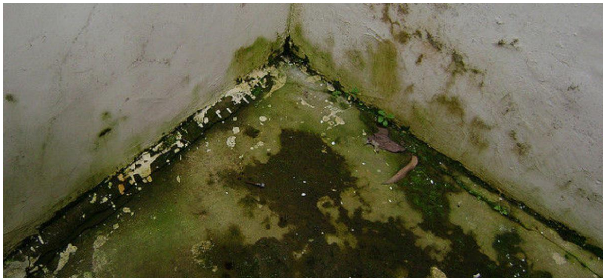
Ilustración 11 hongos en el concreto
