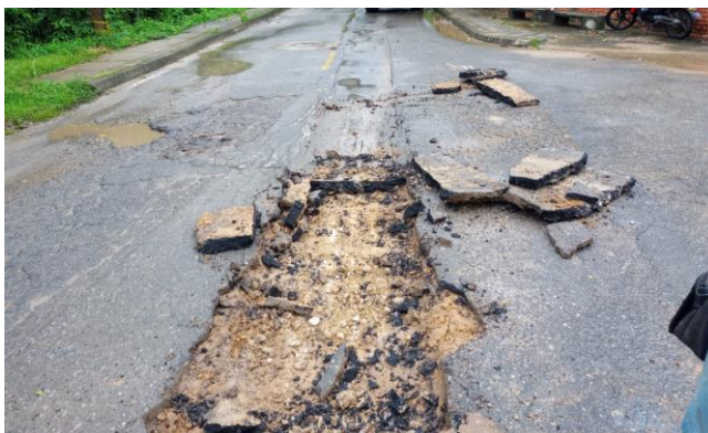
Ilustración 31: asentamiento del asfalto. .
