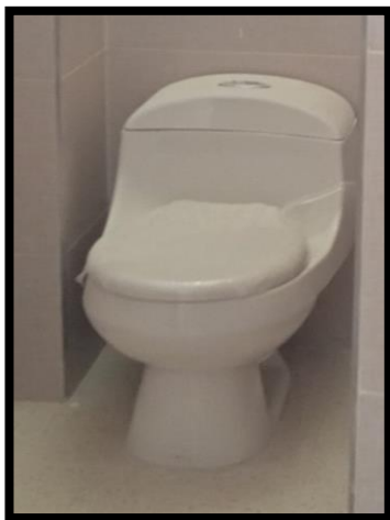
Ilustración 23: Aparato sanitario (Inodoro). Fuente: Propia.
