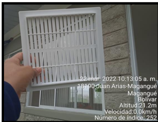
Ilustración 48: Suministros de rejillas plásticas 0,20 X 0,20 m Fuente: Propia.
