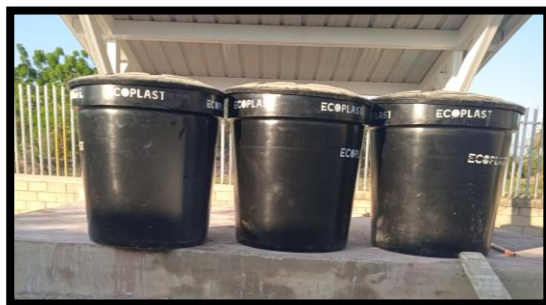
Ilustración 46: Suministros de tanques elevados de 2000 Lts. Fuente: Propia.
