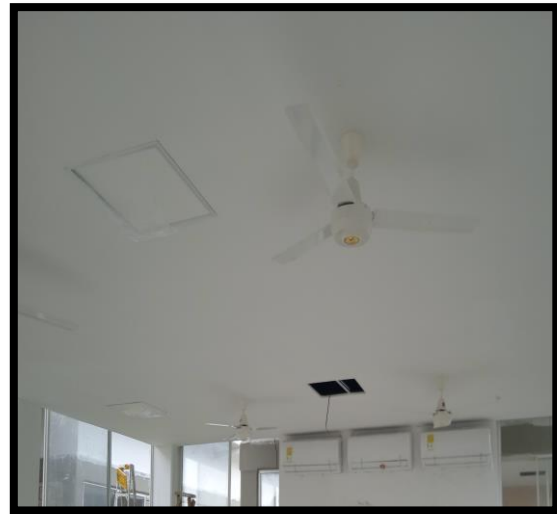
Ilustración 50: Suministros de ventiladores de techo. Fuente: Propia.
