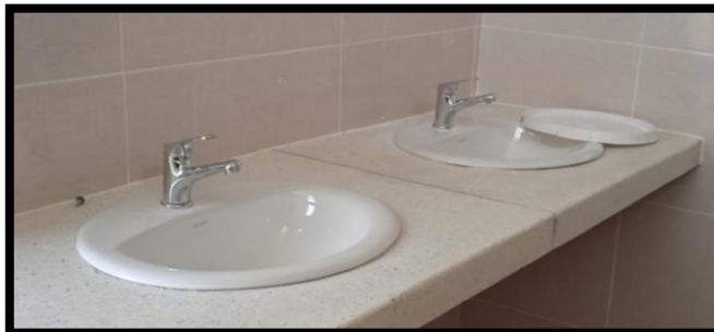
Ilustración 22: Aparatos sanitarios (Lavamanos). Fuente: Propia.
