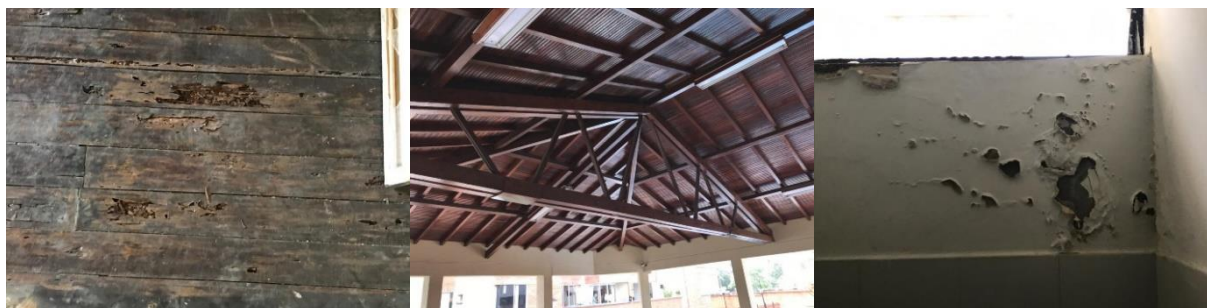
Ilustración 14. Estado de la Madera, Paredes y Cubierta de la Cancha de Squash
