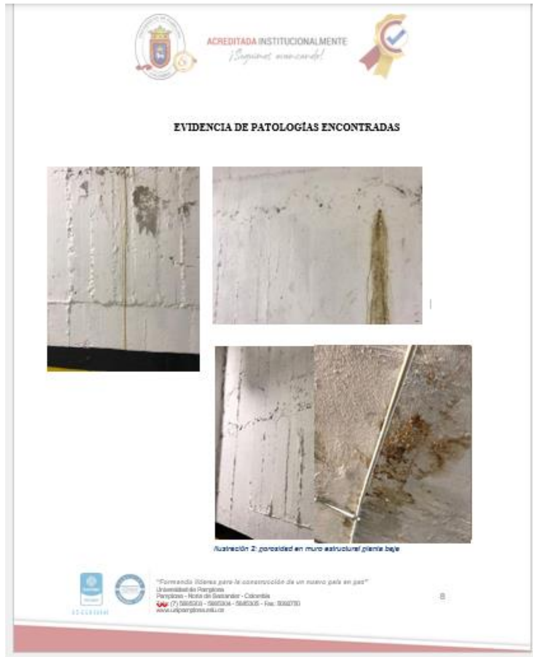
Ilustración 13. Informe de Patología del Conjunto Parquedero Sótano 1
