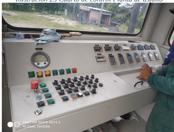
Ilustración 25 Cuarto de control Planta de asfalto
