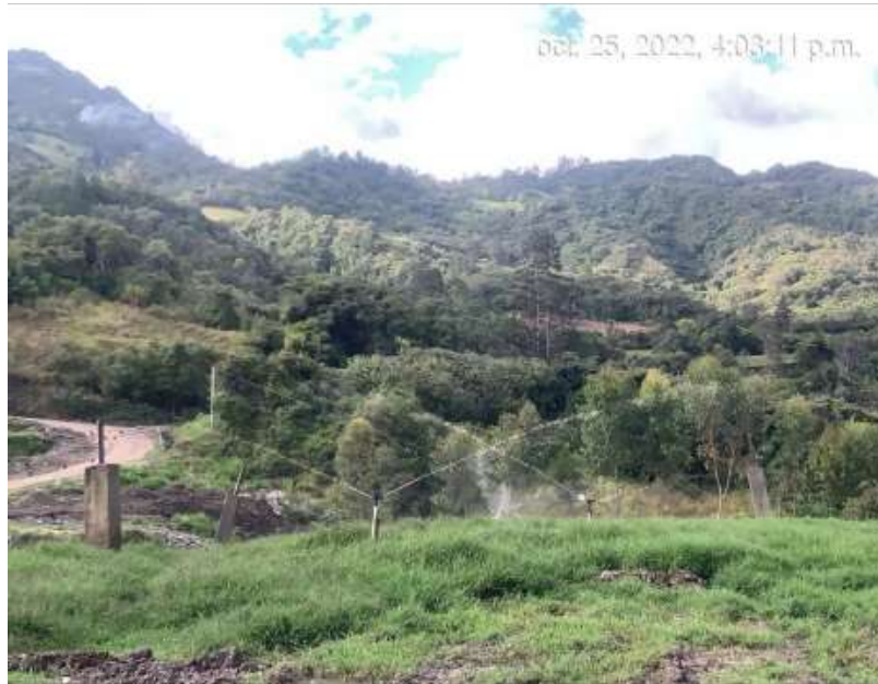
Figura 18. Sistema de aspersión de lixiviados
