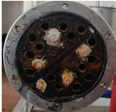
Figura 59. Fallo de obstrucción y atascamiento de cinco tubos.
