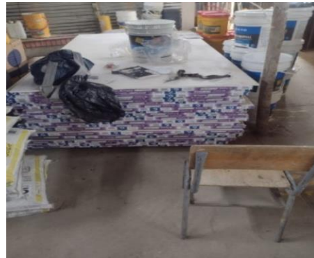
Ilustración 12 Almacenamiento de láminas de drywall
