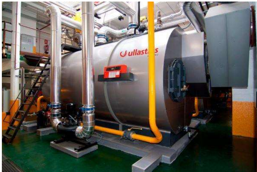
Imagen 4. Caldera de la Central Térmica de Orcasitas. Fuente. https://ullastres.com/central-termica-de-orcasitas-funcionamiento-eficiente/
