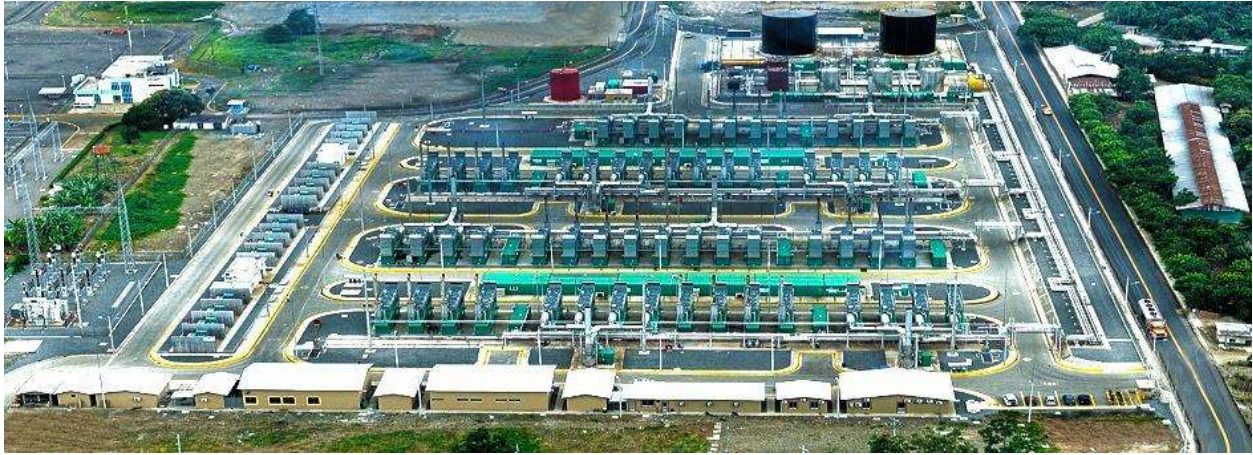
Imagen 9. Subestación Termoeléctrica Quevedo - Conalba. Fuente: https://www.conalba.com/subestacion-termoelectrica-quevedo/
