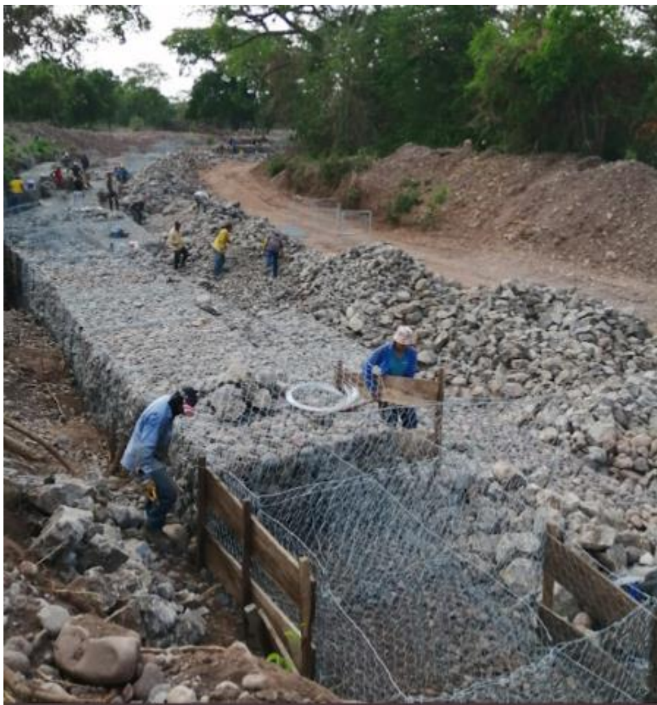
Ilustración 25 Ausencia del geotextil
