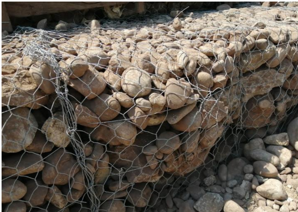
Ilustración 33 Pandeo de la malla
