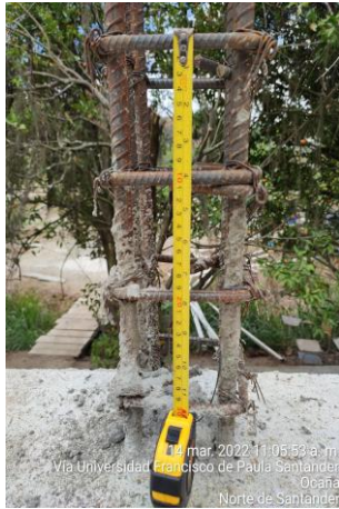
Ilustración 11. Separación estribos en zona de confinamiento de columnas. Fuente: Elaboración Propia.
