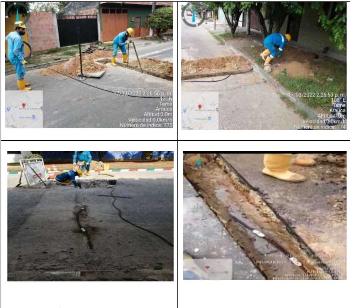
Ilustración 22. Identificación de reparaciones mal ejecutadas
