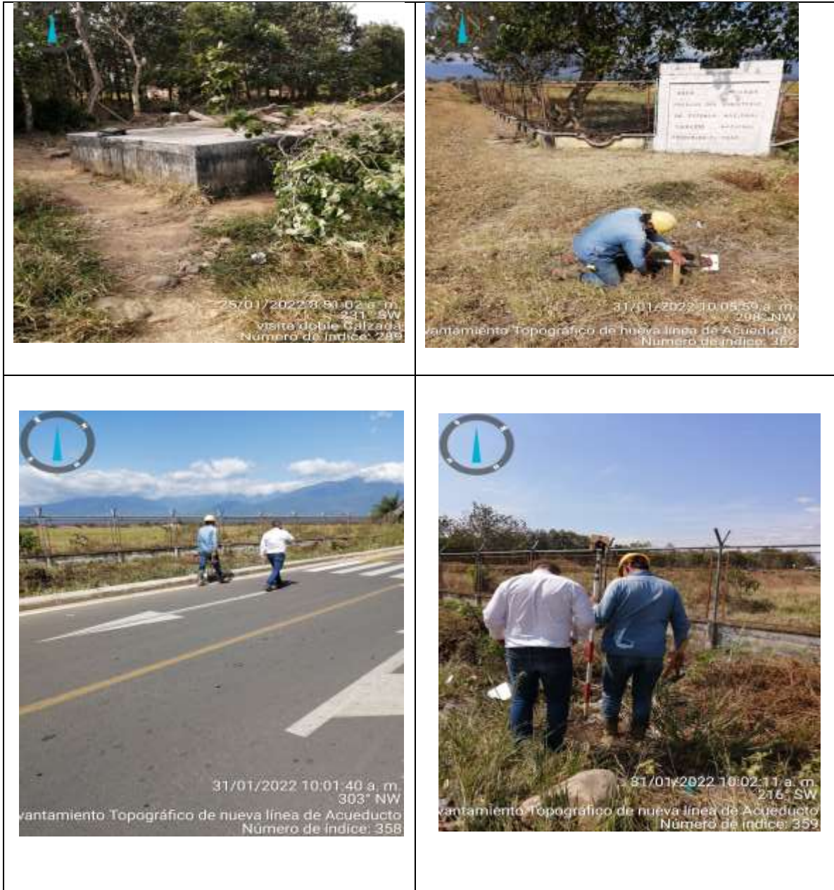
Ilustración 25. Reubicación de macromedidores
