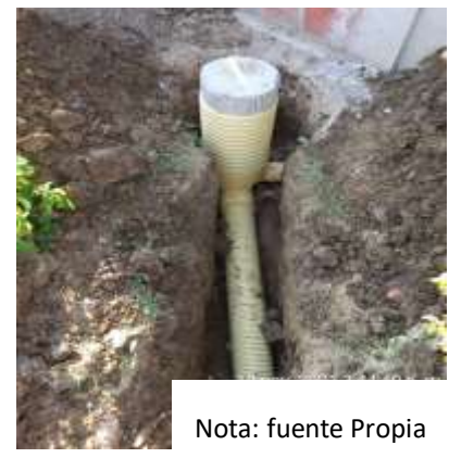
Fotografía 22 Int. Caja de Registro
