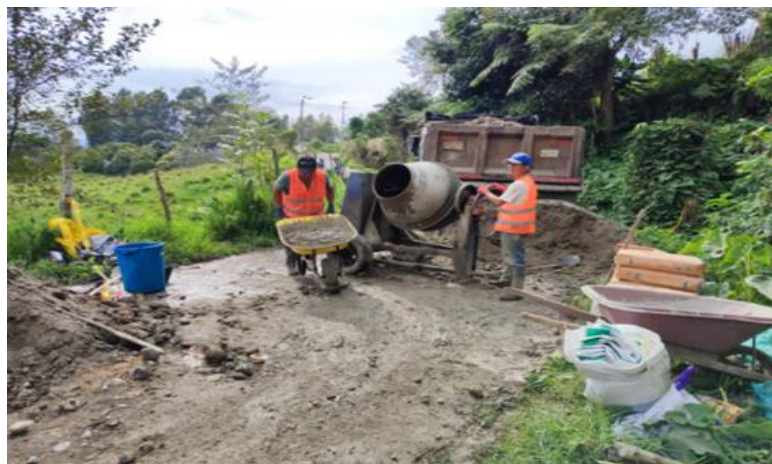
Ilustración 23 Visita técnica en donde se corrobora el cumplimiento del sistema de seguridad y salud en el trabajo, Fuente: Propia
