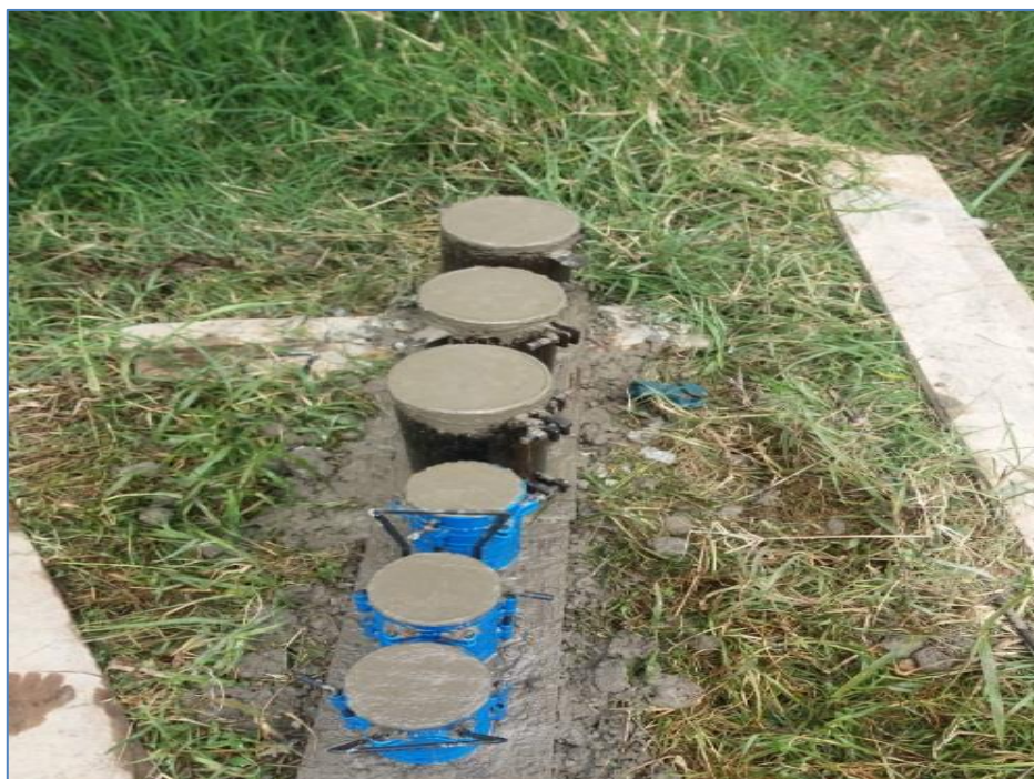
Ilustración 24 Toma de muestras para el laboratorio de resistencia a la compresión, Fuente: Propia
