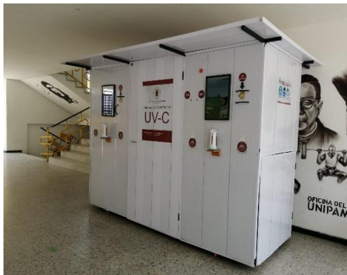
Figura 26. Disposición de cabina de desinfección
