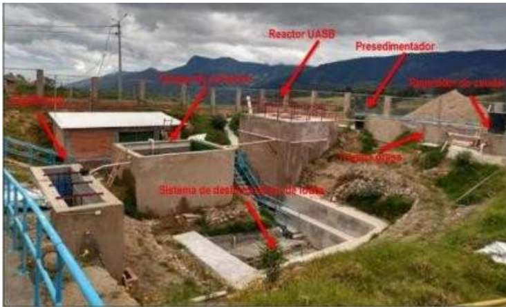
Ilustración 25. Sistema de tratamiento de lixiviados (STL)
