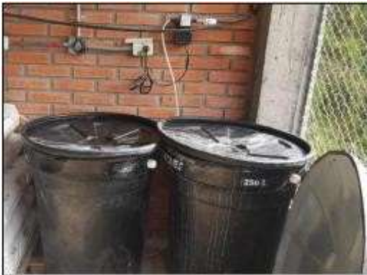
Ilustración 30. Tanques de preparación y dosificación de nutrientes
