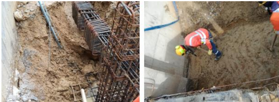
Ilustración 45 Evacuación de agua
