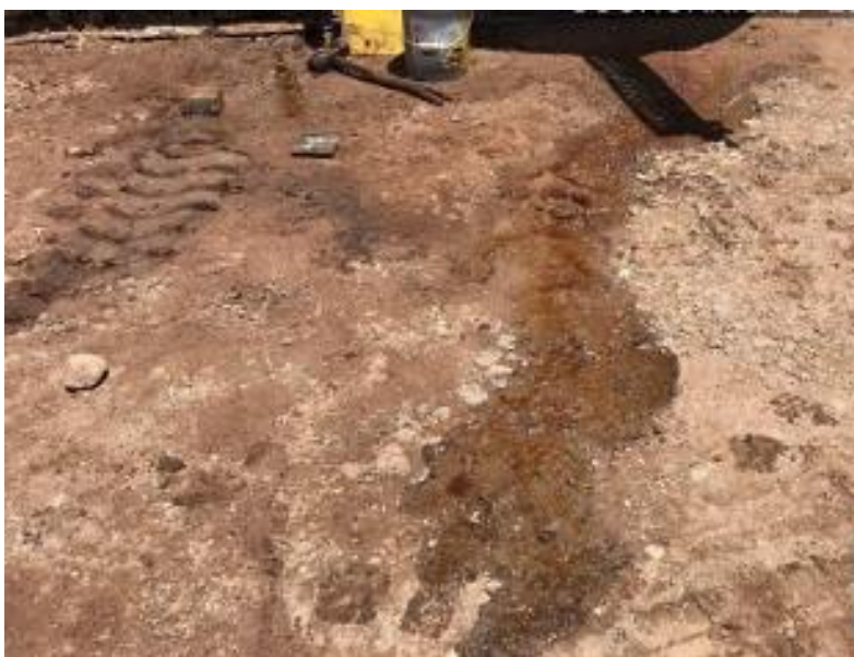
Figura 15: contaminación del suelo por el vertimiento de aceites e hidrocarburos derivados de mantenimiento de maquinaria pesada.
