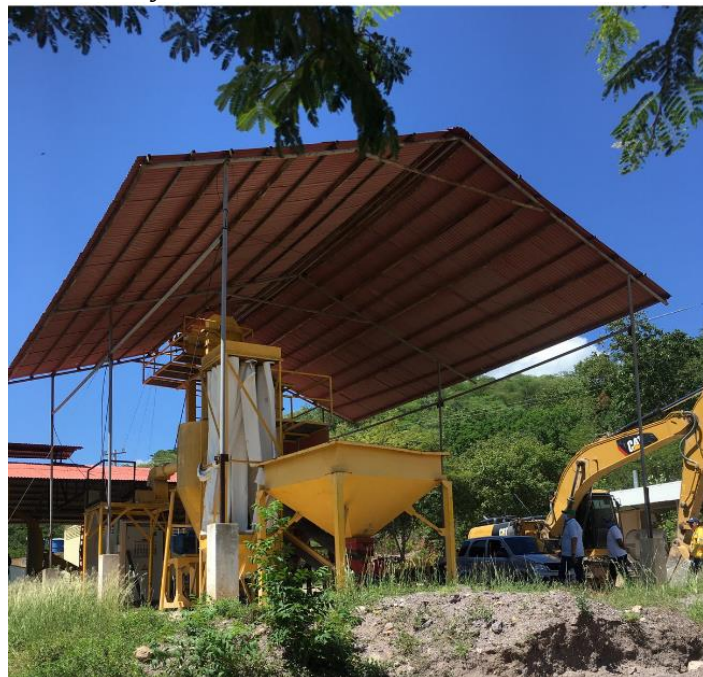
Figura 19: Pulverizador y humectador de minerales instalado en el centro minero.
