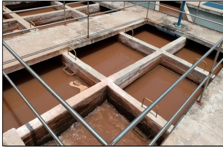
Figura 8. Unidad de Floculadores
