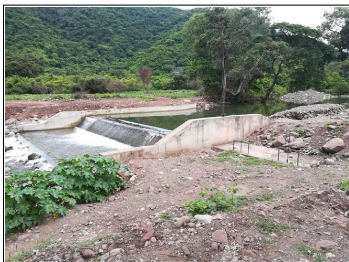
Figura 5. Fuente de abastecimiento (Bocatoma)
