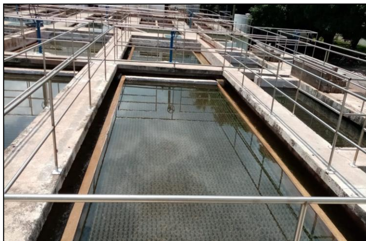
Figura 9. Unidad de Sedimentador
