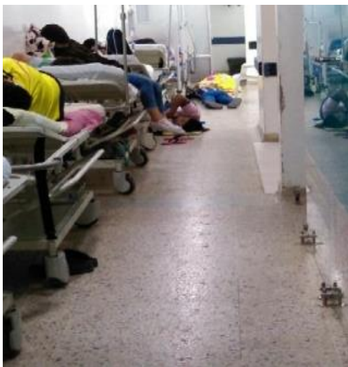
Ilustración 15. Estado piso 1 urgencias fuente: Gobernación de Arauca.
