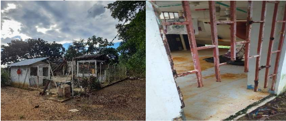
Figura 6 Acueducto Municipal de Miraflores Guaviare
