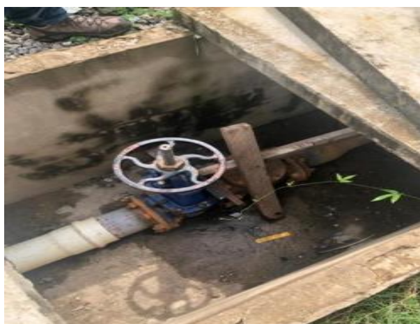
Figura 7. Válvula de compuerta de los pozos subterráneos.
