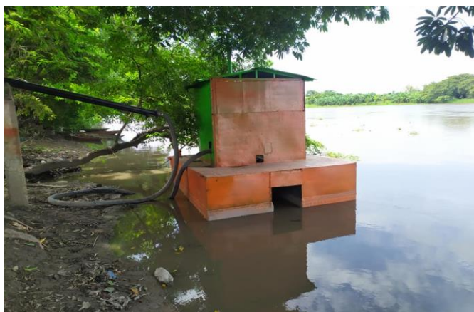
Figura 5. Bocatoma en el Rio Magdalena.
