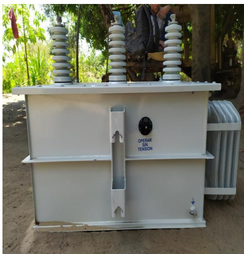
Figura 23. Equipo para la bomba principal
