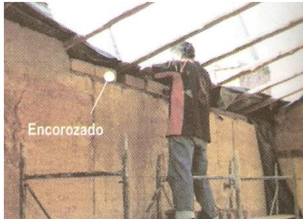
Gráfico 183: Encorozado en muro de Tapia Pisada. Fuente: Arquitectura de tierra, sustentabilidad y cultura. Noviembre 2016.
