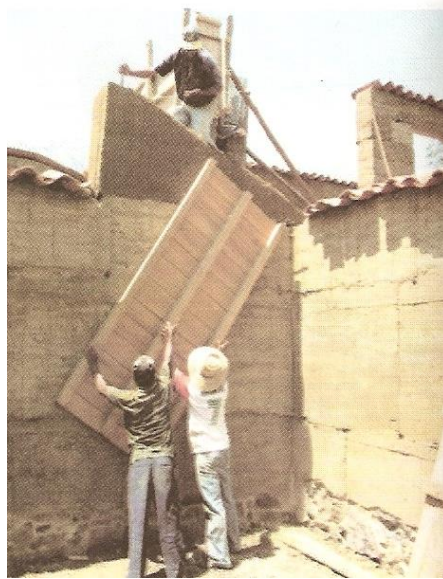
Gráfico 178: Armadas del Tapial para la construcción en tierra. Fuente: Arquitectura de tierra, sustentabilidad y cultura. Noviembre 2016.
