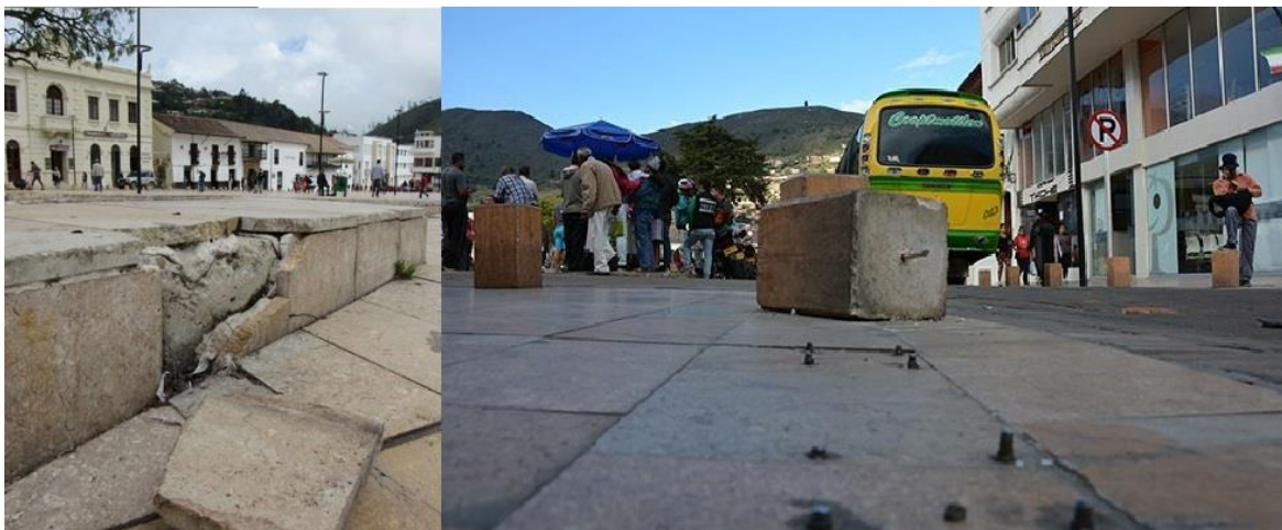
Ilustración 16: Deterioro y malas condiciones presentadas en la Plaza Águeda Gallardo.
