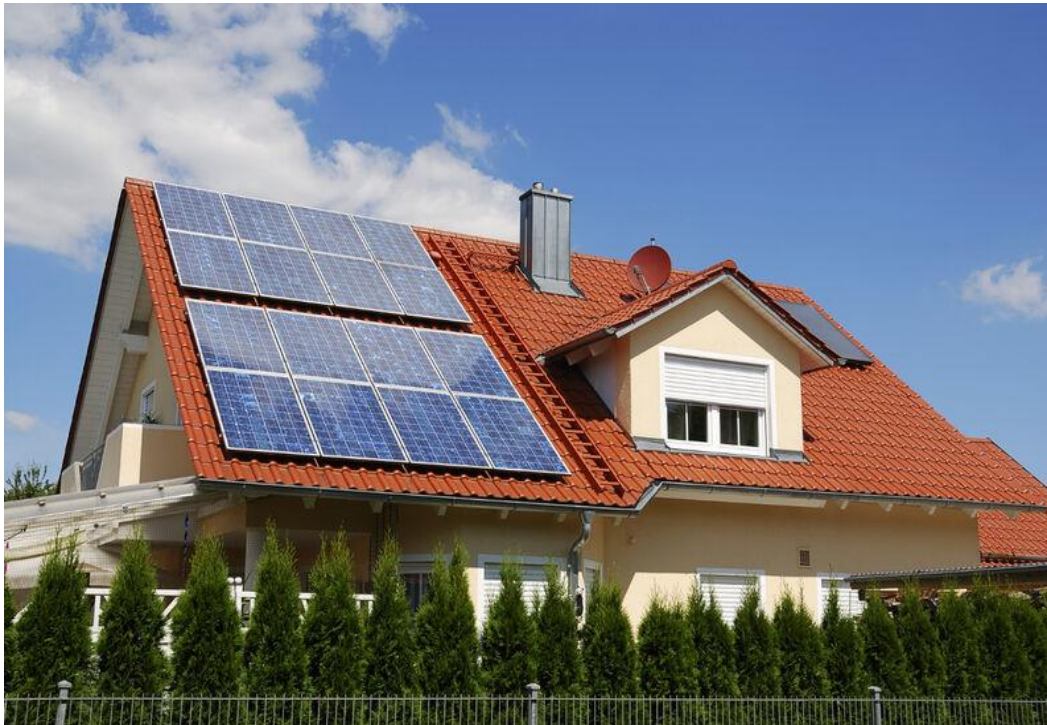
Ilustración 2.3.3-1 Vivienda con energía fotovoltaica
