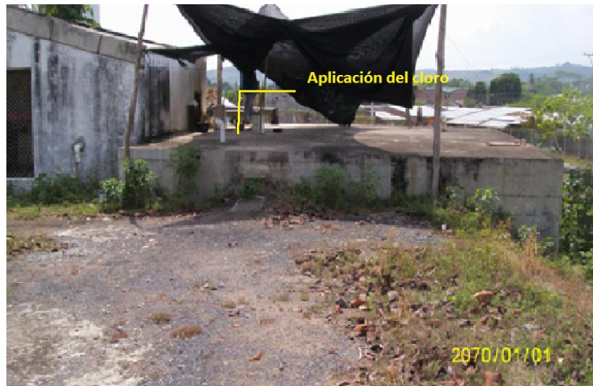
Imagen 7. Tanque de almacenamiento superficial 130 m 3 .
