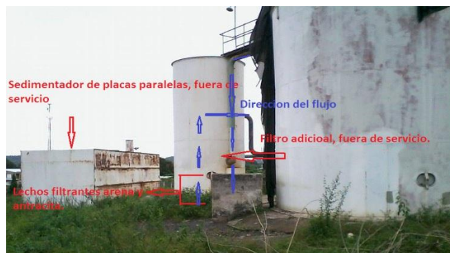
Imagen 6. Funcionamiento del filtro adicional fuera de servicio.
