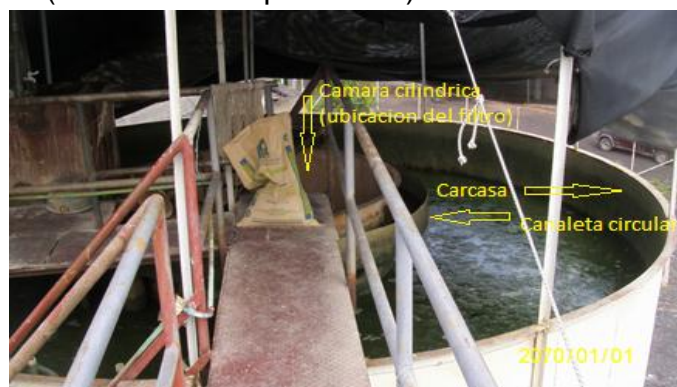
Imagen 4. Carcasa (Sedimentador perimetral).
