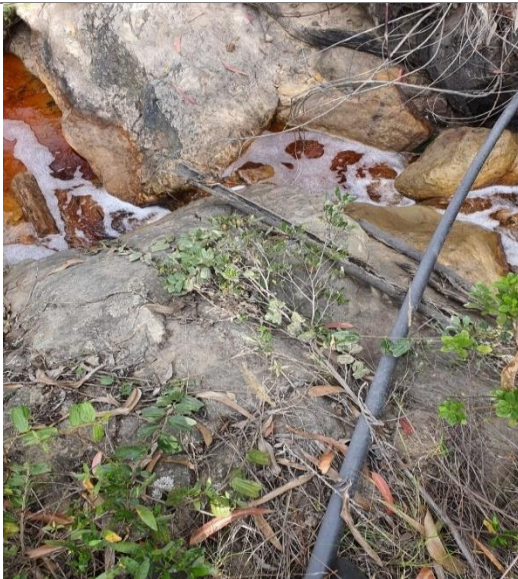
Fotografía 5. Segunda afectación por disposición de aguas de subterráneas en el drenaje
